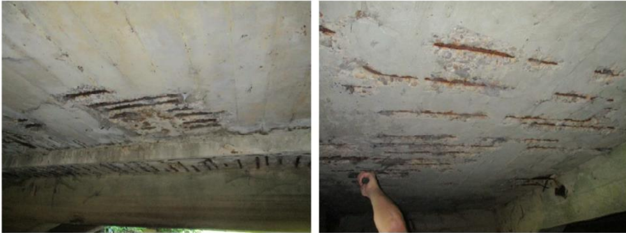
Figuur 1: foto's van het schadebeeld duiker Boksloot (Westenberg, Co. 107-012-v2)
